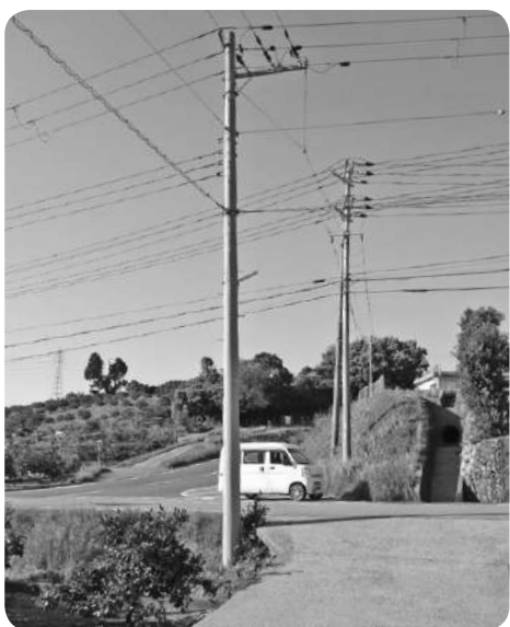
町有地内の電柱
